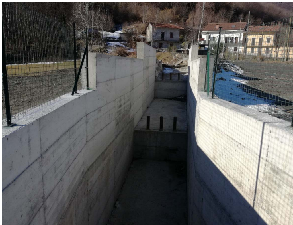
Figura 18 Vista da valle verso monte in corrispondenza del manufatto di imbocco del nuovo by-pass
