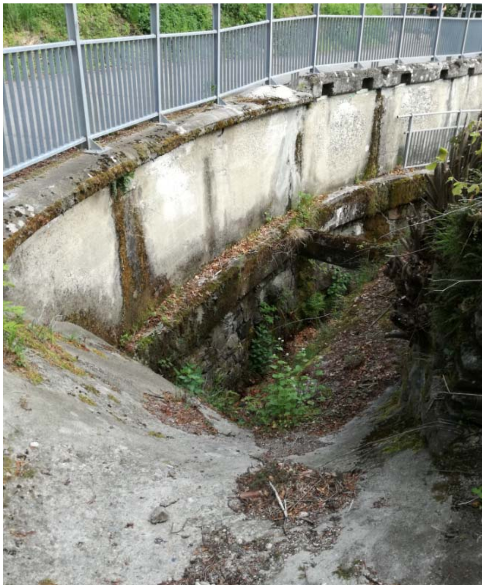
Figura 10 Tratto a valle della vasca di monte, comba Marquetta in parallelo al canale idroelettrico
